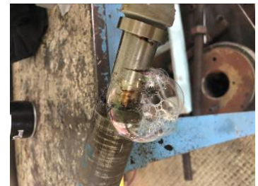
C) 漏れ状態
